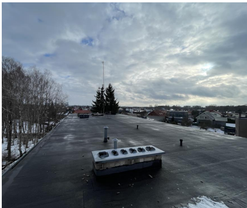
Pav. 10. Bendra stogo būklė
