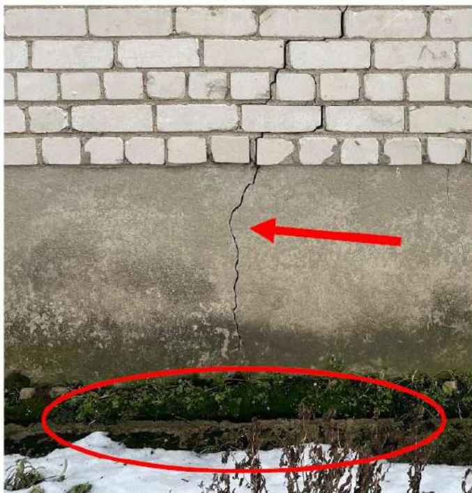
Pav. 7. Cokolio ir nuogrindos defektai
