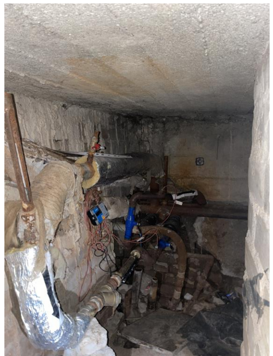
Pav. 13. Komunikacijų vamzdynai
