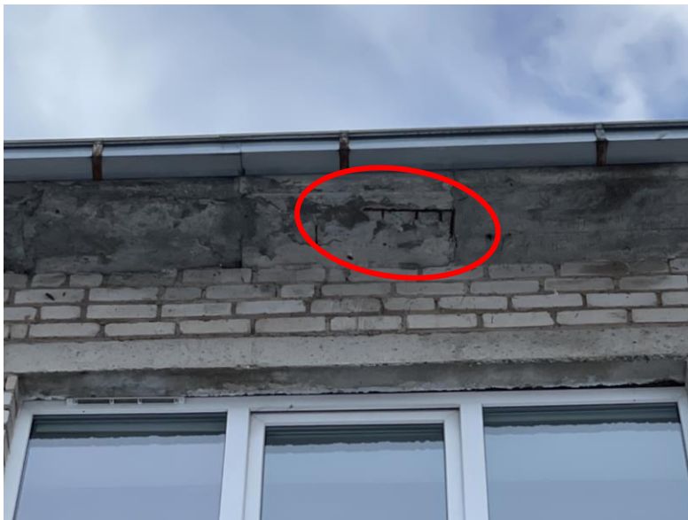
Pav. 12. Stogo defektai: pažeistas karnizų apsauginis betono sluoksnis
