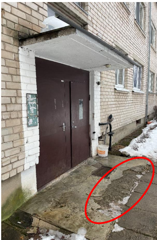
Pav. 9. Įėjimo defektai: ištrupėjęs aikštelės betonas
